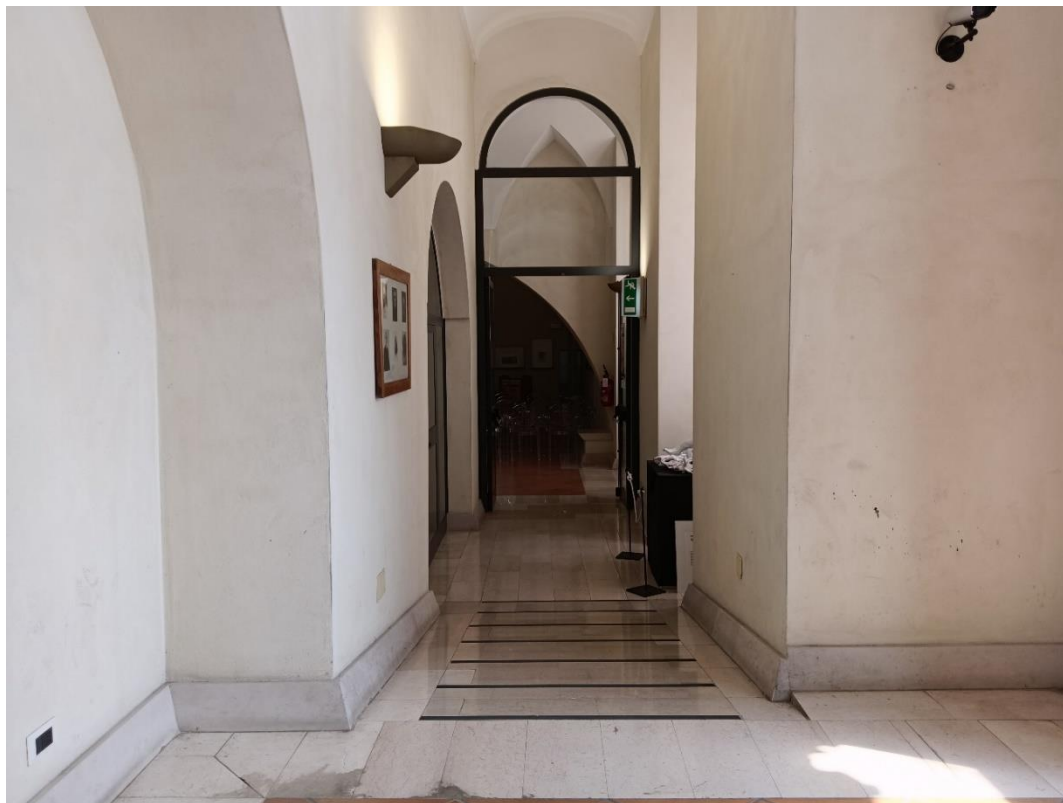
Corridoio -Rampa (05) - prossima alla porta di accesso ai bagni – Criticità per disabilità
